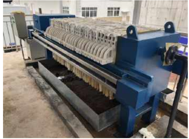
一般废水处理系统
