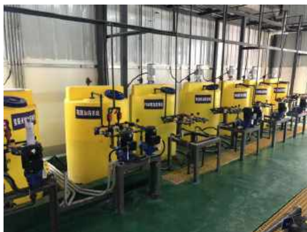
含铬含镍废水处理装置
