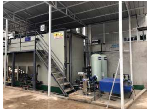
含铬含镍废水处理装置
