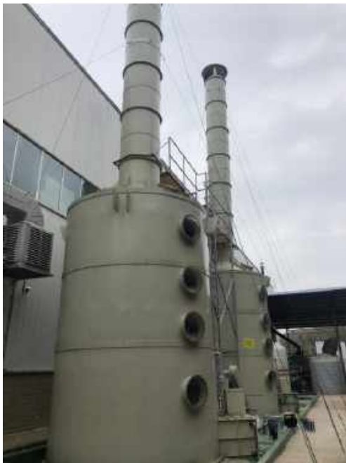
碱雾酸雾处理装置
