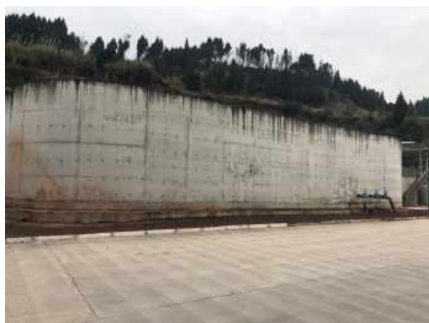
应急事故池和消防池
