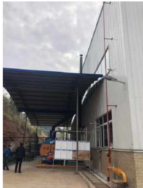
燃气锅炉排气筒
