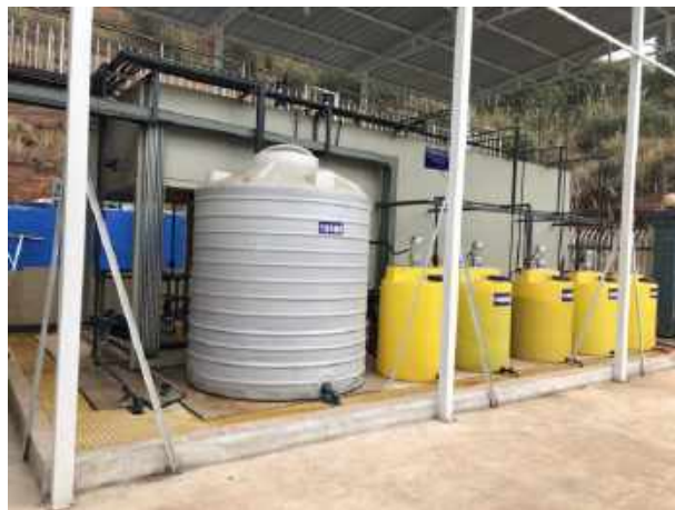
一般废水处理系统
