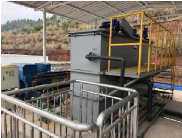
一般废水处理系统
